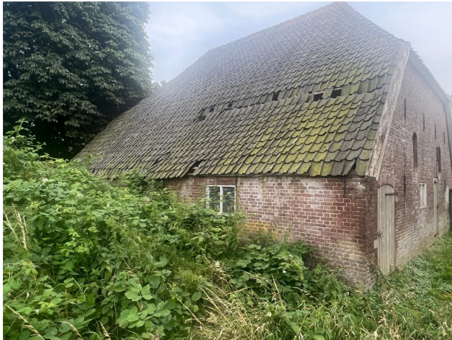
De Veldschuur in deplorabele toestand...
